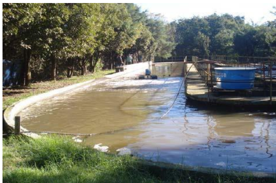
Figura 02 - Estação de Tratamento de Esgoto-Valo de Oxidação – Fonte: CASAN.
